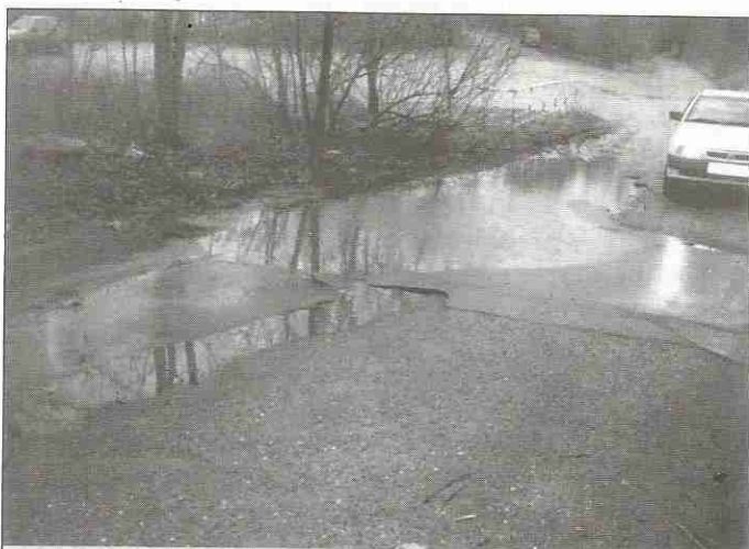
Przykład zniszczonej drogi lokalnej (ul. Zdrojowa) spowodowany zaniedbaniami melioracyjnymi, znajdującej się w bezpośrednim sąsiedztwie jeziora Jasień po stronie wschodniej jeziora.
